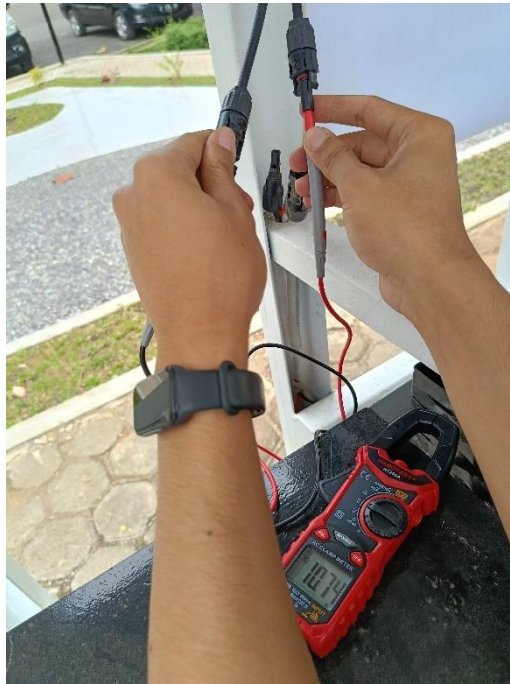
Gambar L.5 Gambar Pengukuran Tegangan Panel Surya 1
