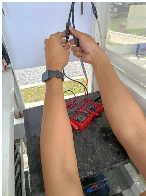
Gambar L.6 Gambar Pengukuran Tegangan Panel Surya 2
